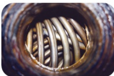
Widok rurek wymiennika typu JAD po 2 godzinach procesu chemicznego oczyszczania.
